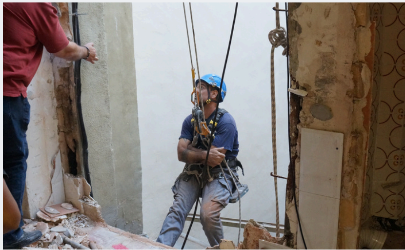
ANTES - DERRIBO PARA FACHADA COMERCIAL Casa de 1900 para transformar en restaurant fusión moderno.
